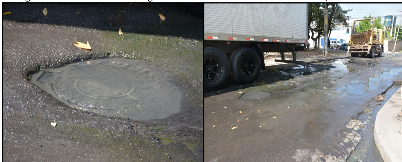
Figura 4 – Extravasamento de esgoto bruto em PV no bairro Tancredo Neves, em 15/08/2018
