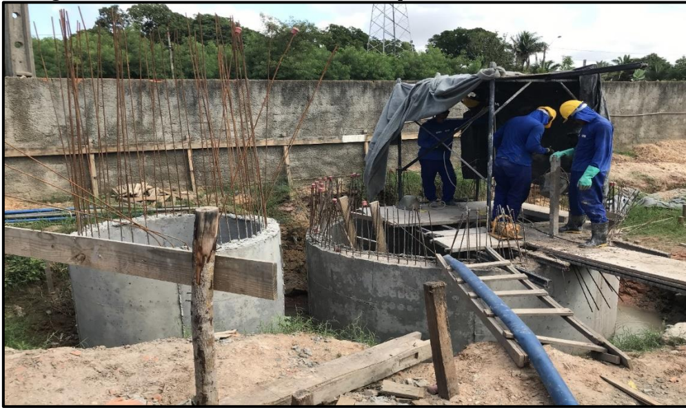
Legenda: PV de entrada da ETE (esquerda) e Tanque da EEEB (direita). Fonte: Autoria Própria.
