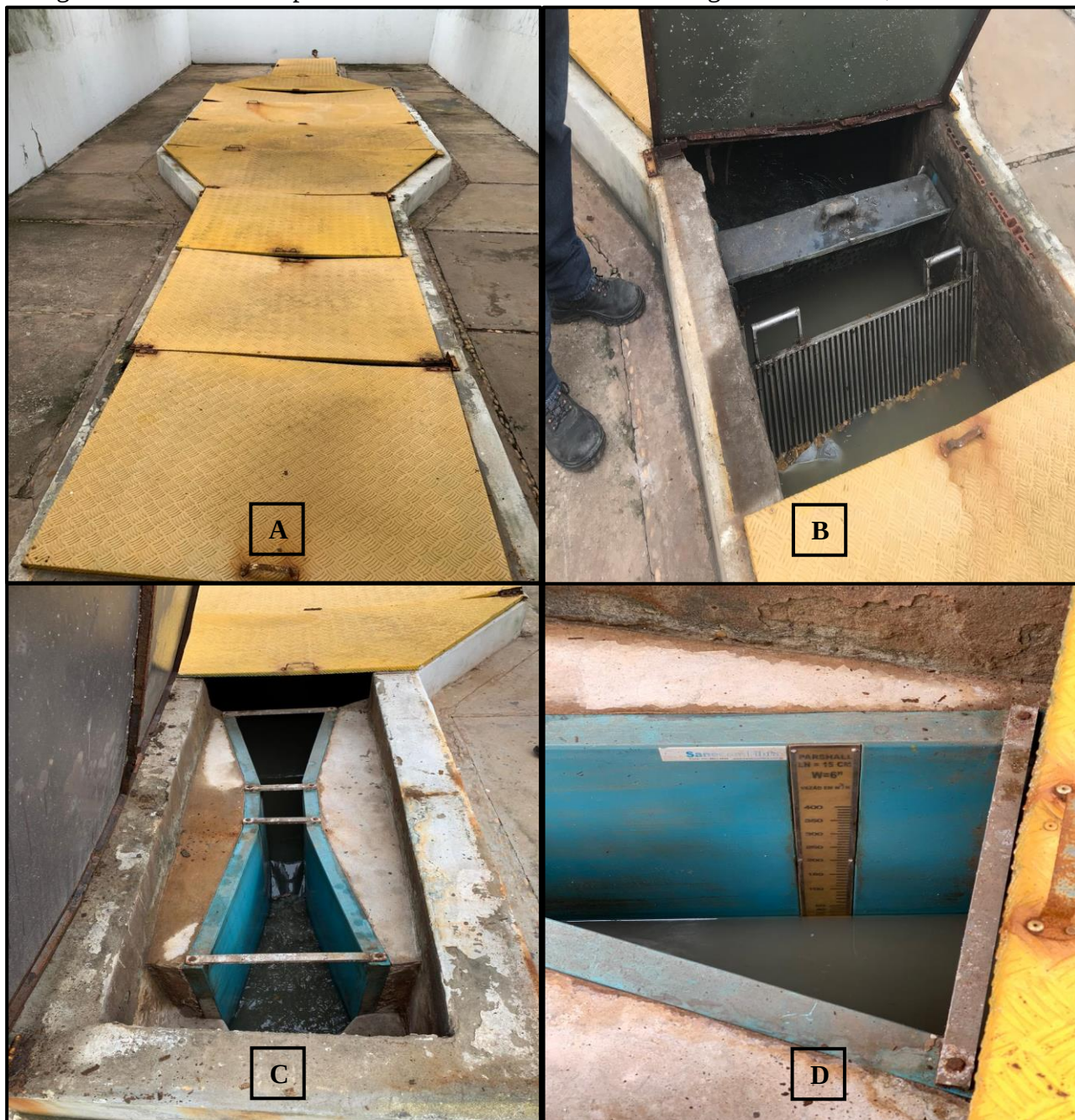
Figura 10 – Tratamento preliminar e calha Parshall da ETE Sigefredo Pacheco, em 20/02/2020
