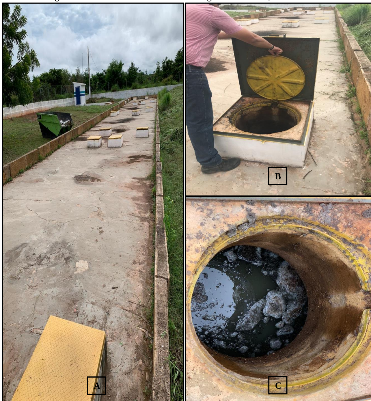
Figura 12 – Reatores anaeróbios da ETE Sigfredo Pacheco, em 20/02/2020.
