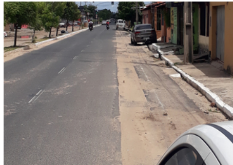
Figura 15 – Desnívelamento de recomposição asfáltica em valas na Av. Centenário, bairro Aeroporto.
