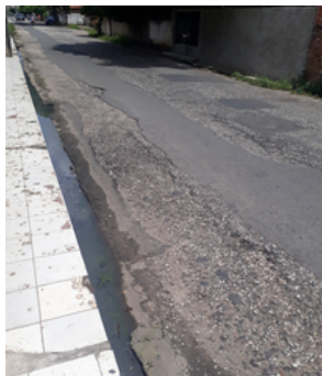
Figura 12 – Rebaixamento de recomposição asfáltica, Rua Primeiro de Maio, bairro Real Copagre.
