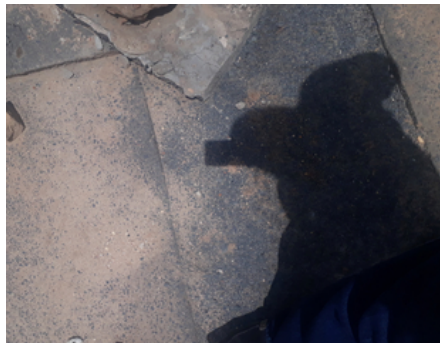
Figura 9 – Desnível de vala, sem recomposição asfáltica, na Rua Coelho de Resende, bairro Aeroporto.
