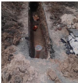
Figura 5 – Espera de ligação sanitária, sem proteção próxima, na Rua Coelho de Resende, bairro Aeroporto
