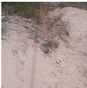
Figura 10 – Calçada, sarjeta e pavimento danificados por maquinário pesado, na Rua Coelho de Resende, próxima a Rua Rosemary Santos, bairro Aeroporto.
