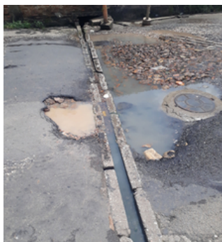
Figura 11 – Poço de visita, na Rua Primeiro de Maio, bairros Real Copagre e Itaperu.
