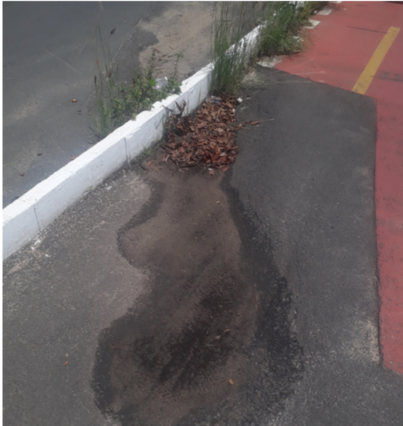
Figura 1 – Rebaixamento de recomposição asfáltica sob meio fio e pista de ciclistas, cruzamento da Rua Picos com Av. Odilon Araújo, bairro Monte Castelo
