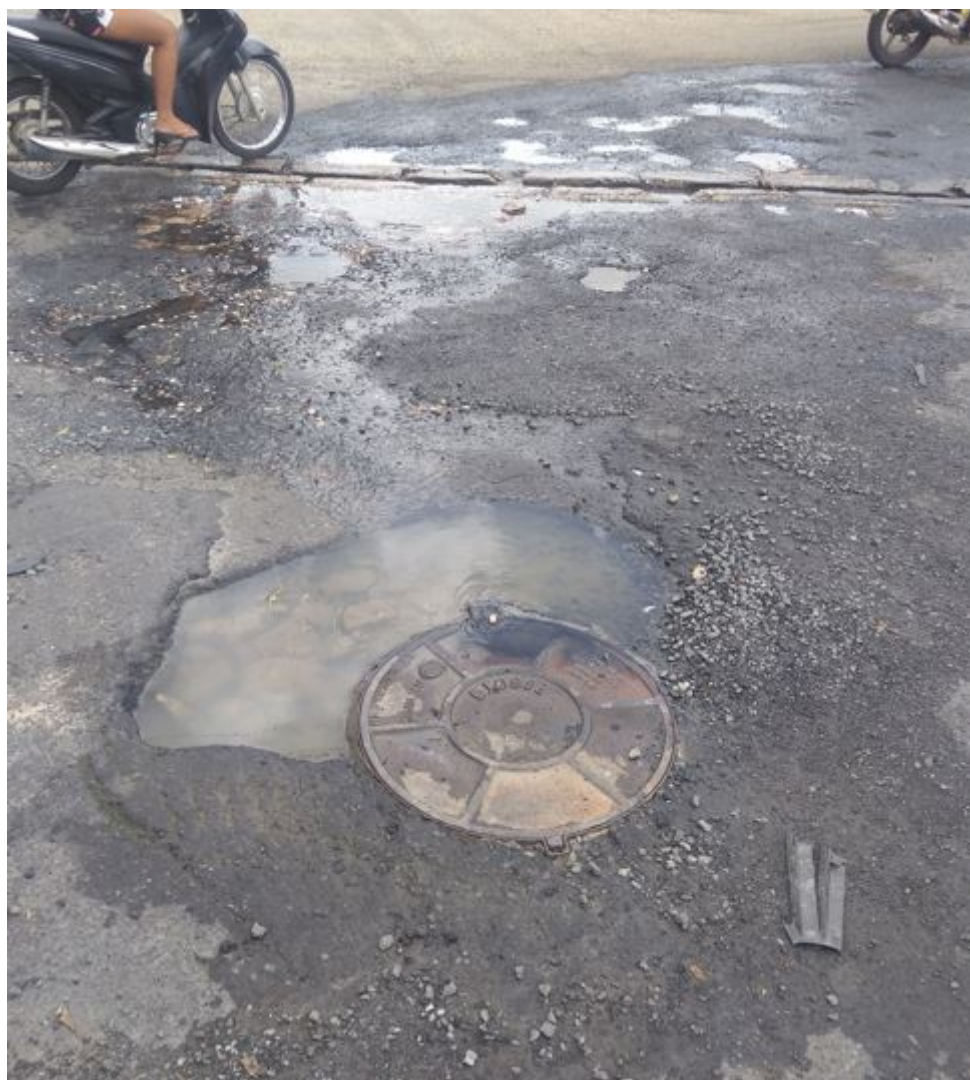
Figura 14 – Poço de visita com vazamento e danos ao pavimento asfáltico, esquina da Rua Primeiro de Maio com a Av. Centenário
