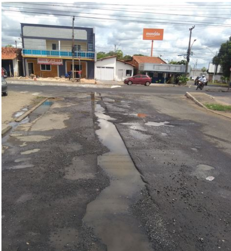
Figura 22 – Esquina da Av. Centenário com a Av. Roraima, trecho sem recomposição do asfalto, com água de sarjeta acumulada.
