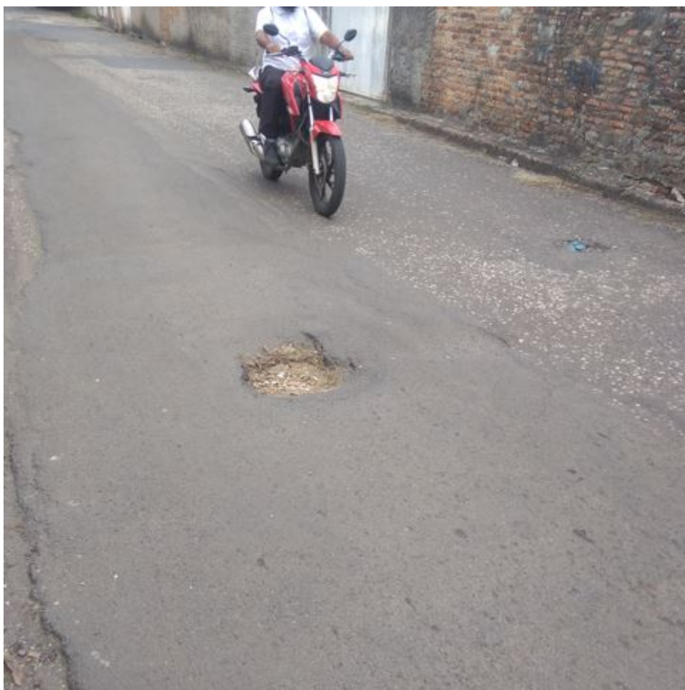
Figura 13 – Buraco em recapeamento asfáltico de vala na Rua Primeiro de Maio, próximo à Rua Aquarius
