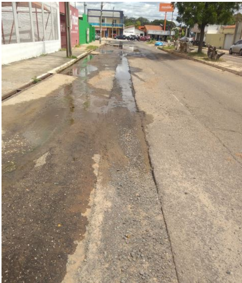
Figura 17 – Pista sem recomposição, trecho da Av. Guaporé, entre as Av. Centenário e Rua Coelho de Resende, lado do sentido zona Leste da via.
