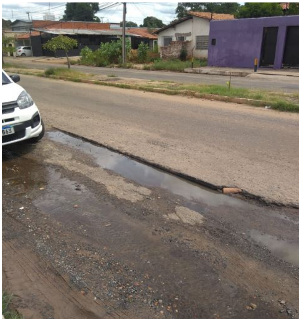
Figura 21 – Esquina da Av. Centenário com a Av. Guaporé, sem recomposição do asfalto, com água de sarjeta acumulada.
