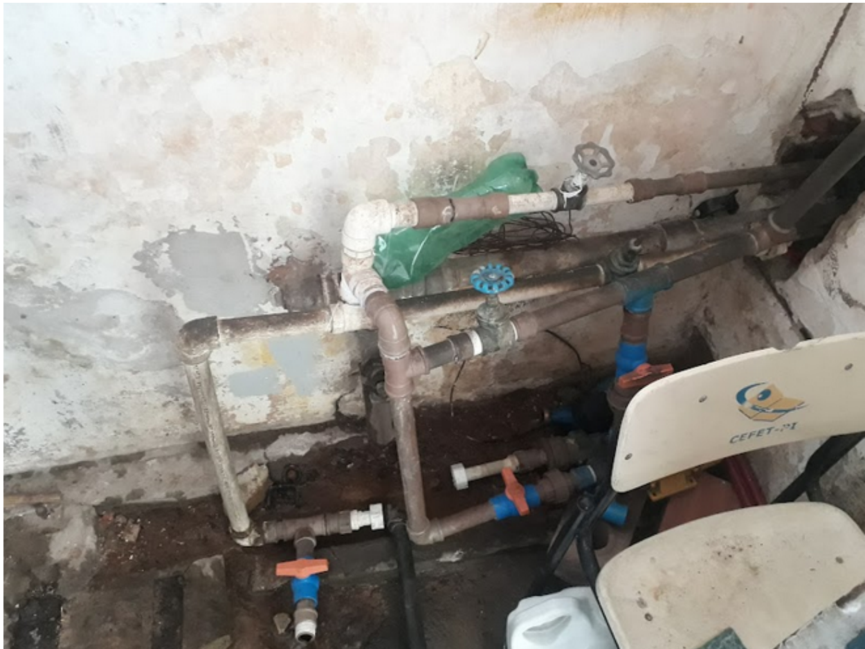
Figura 1 – Ramal de entrada e derivação dos sistemas de abastecimento de água do IFPI. Neste momento, sendo alimentado por caminhão pipa.
