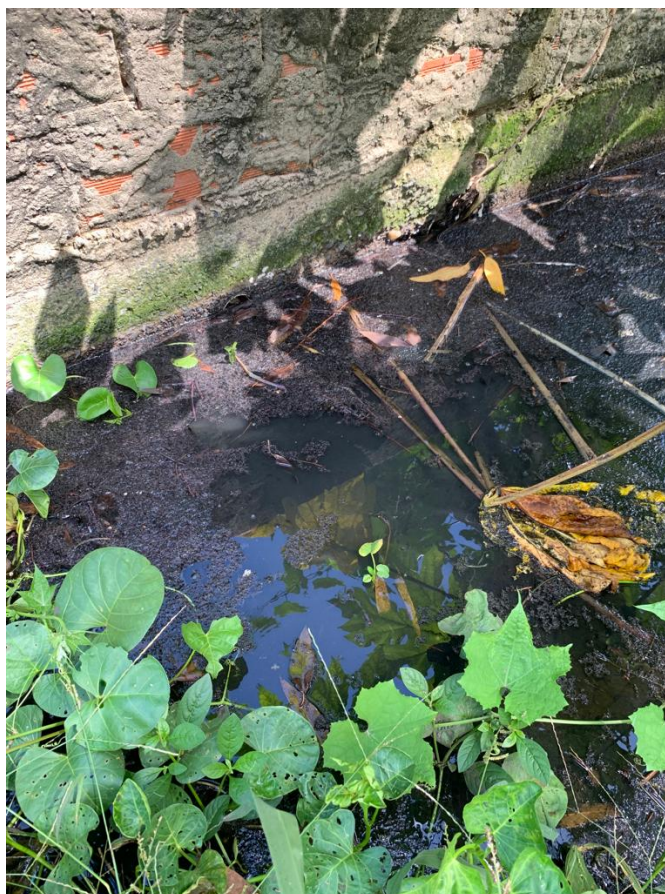
Fonte: Autoria própria (2023) Figura 7 - extravasamento do poço de infiltração
