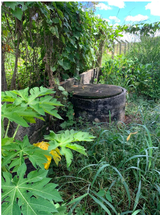
Fonte: Autoria própria (2023) Figura 7 - Poços de infiltração extravazando
