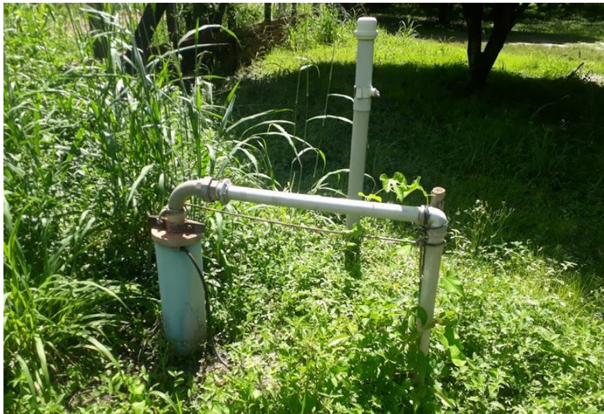
Figura 3 – Poço da Associação de Moradores. Nota-se o clorador não ligado ao sistema de captação.
