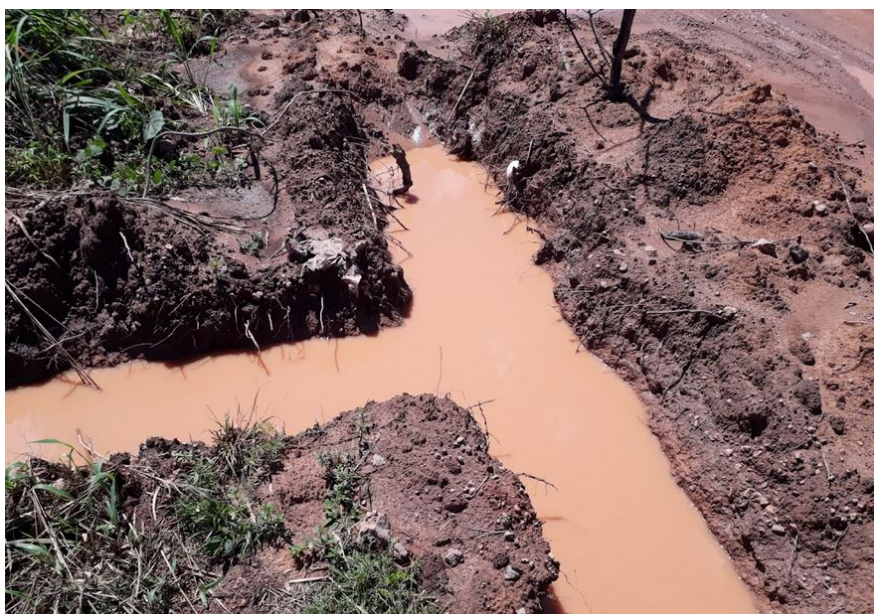
Figura 10 – Vala aberta com acúmulo de água da chuva na estrada de acesso do Soturno.
