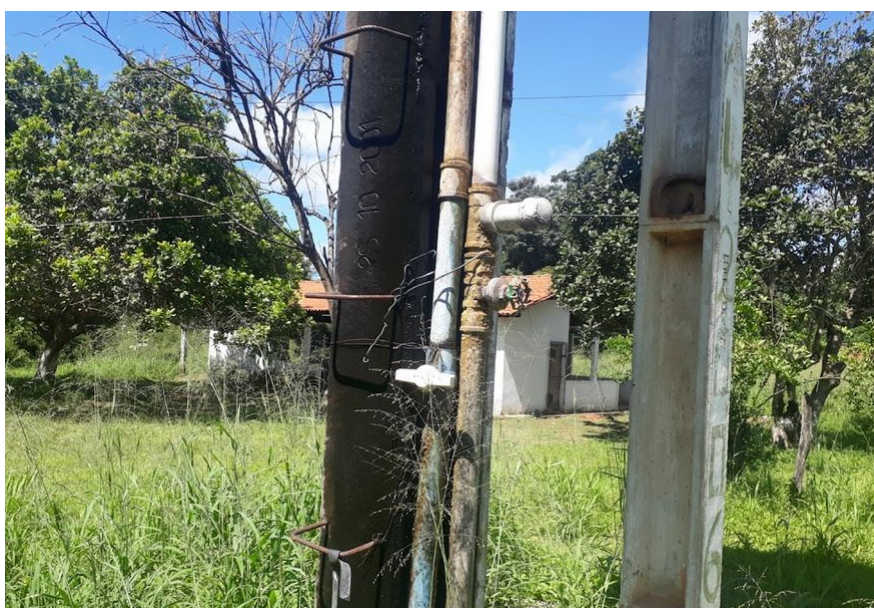
Figura 6 – Registro da caixa d'água. Foi identificado um vazamento.
