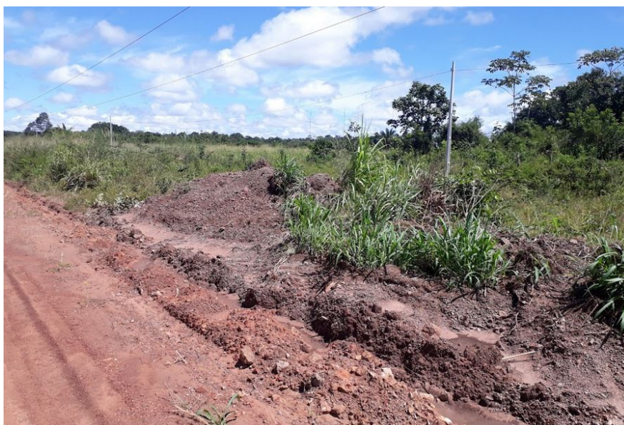
Figura 12 – Deposição irregular de material de escavação de valas na lateral da estrada de acesso do Soturno.
