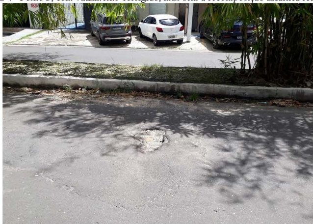
Figura 4 - Ponto 3, com vazamento corrigido, mas sem a recomposição asfáltica realizada.
