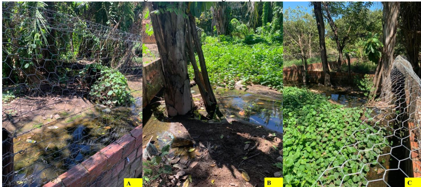
Figura 6 - Acúmulo de esgoto na propriedade
