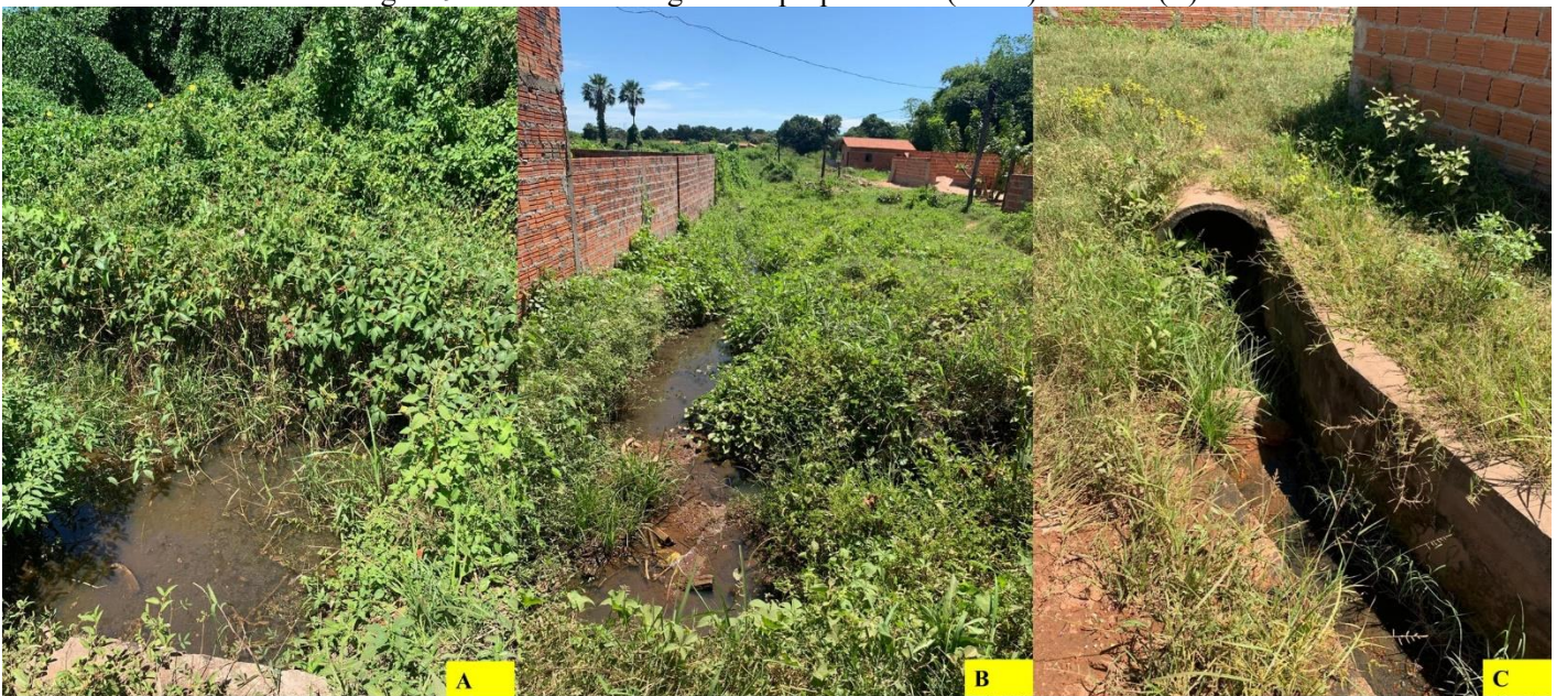
Figura 9 - Acúmulo de esgoto nas propriedades (A e B) e Bueiro (C)
