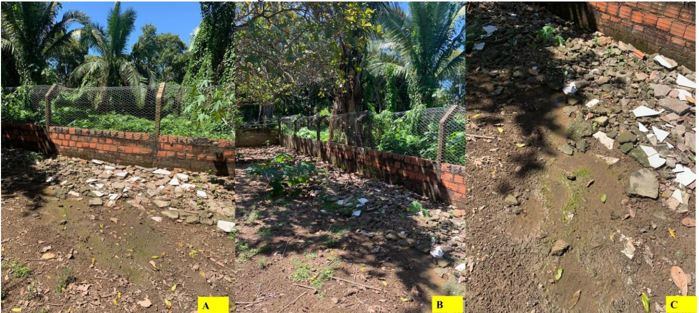
Figura 8 - Muro com entulho na base
