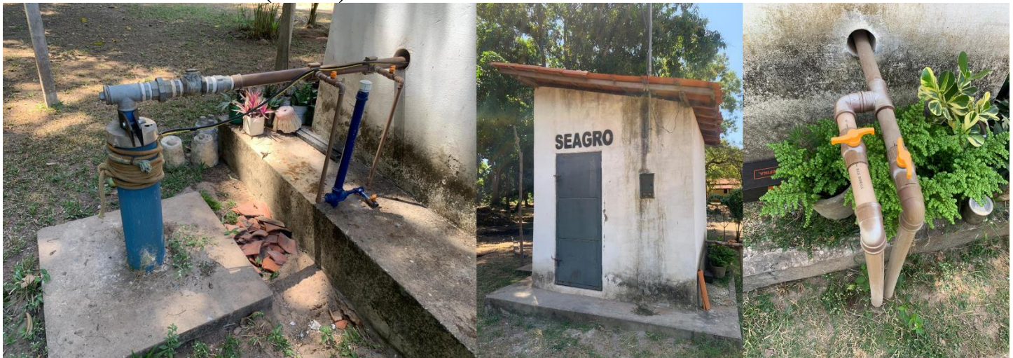
Figura 8 – Sistema de desinfecção (à esquerda), Casa de comando elétrico (ao centro) e manobras do sistema (à direita)
