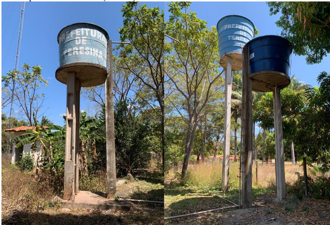
Figura 5 – Reservatório desativado (à esquerda) e Reservatório que alimenta a escola, posto de saúde e parte da comunidade (à direita)
