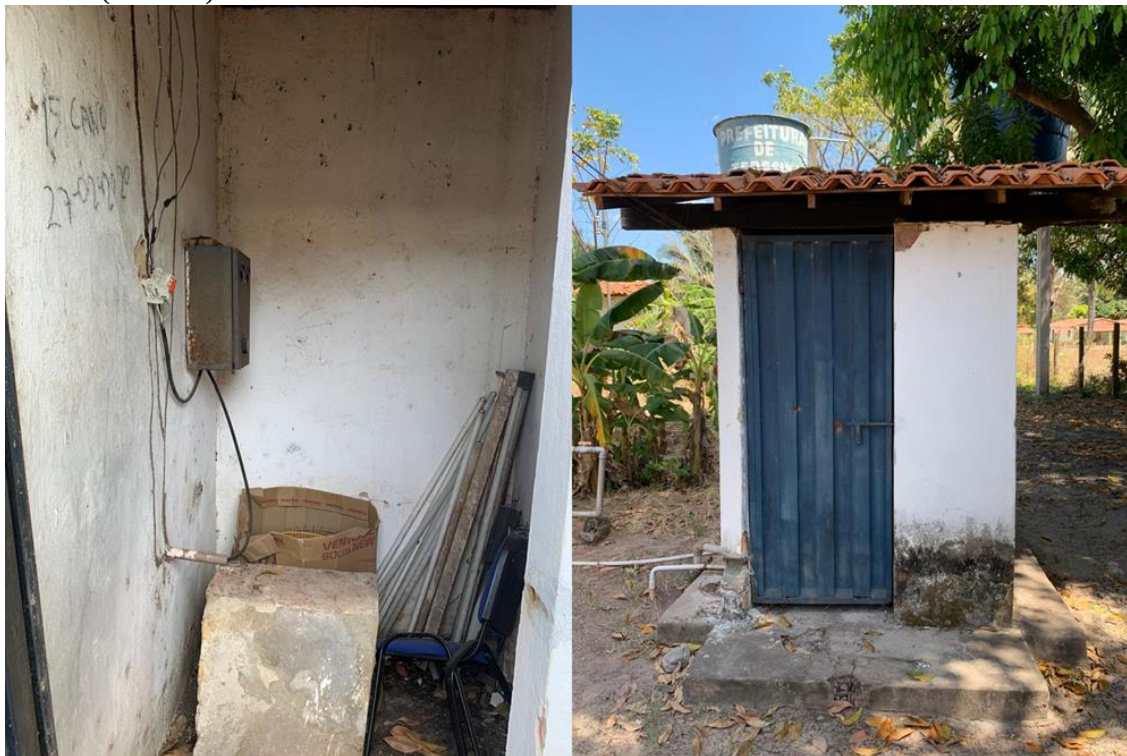
Figura 7 – Quadro de comando elétrico (à esquerda) Casa de abrigo do quadro de comando elétrico (à direita)
