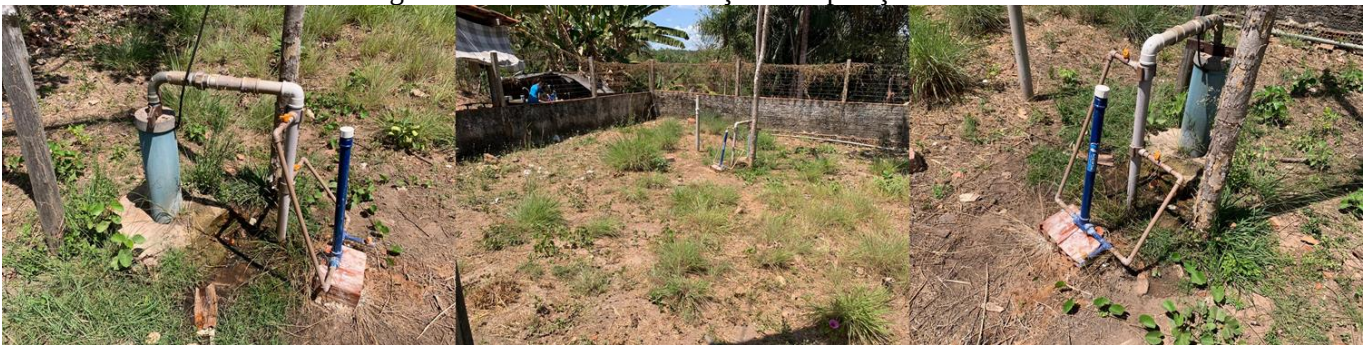
Figura 2 - Sistema de desinfecção em operação.
