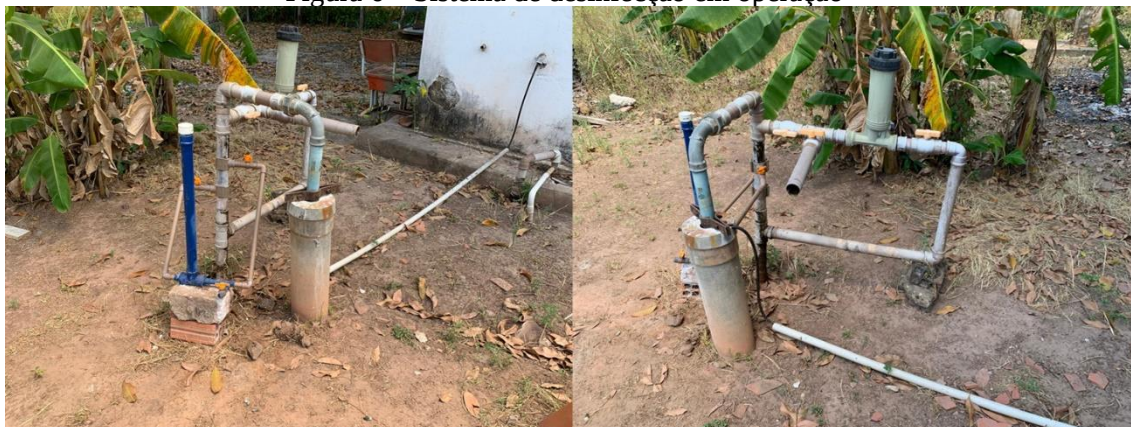
Figura 6 – Sistema de desinfecção em operação
