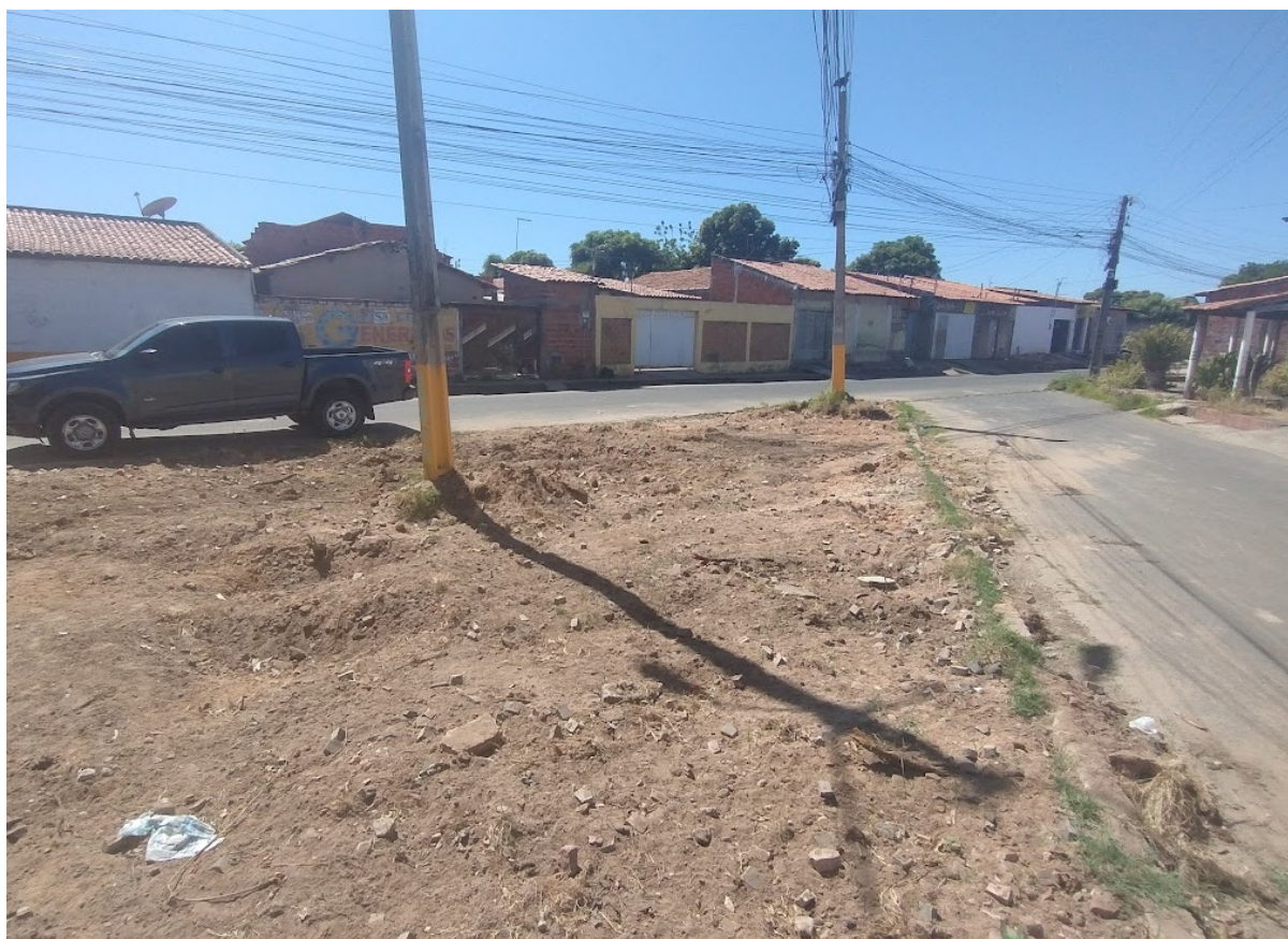
Figura 4 - Cruzamento das Ruas Altos e Granito, sem intervenções aparentes da Águas de Teresina.
