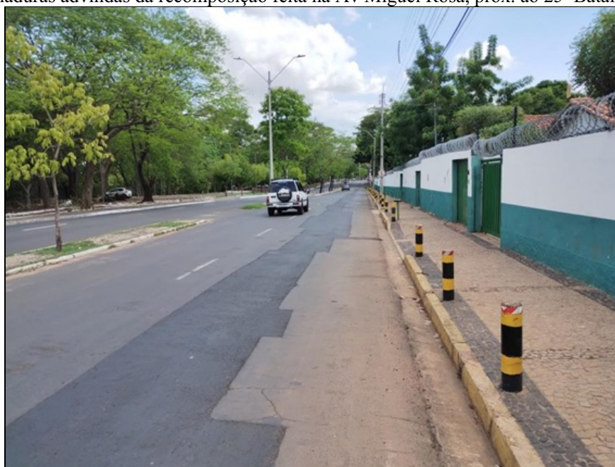
Figura 18 – Rachaduras advindas da recomposição feita na Av Miguel Rosa, próx. ao 25ª Batalhão de Caçadores
