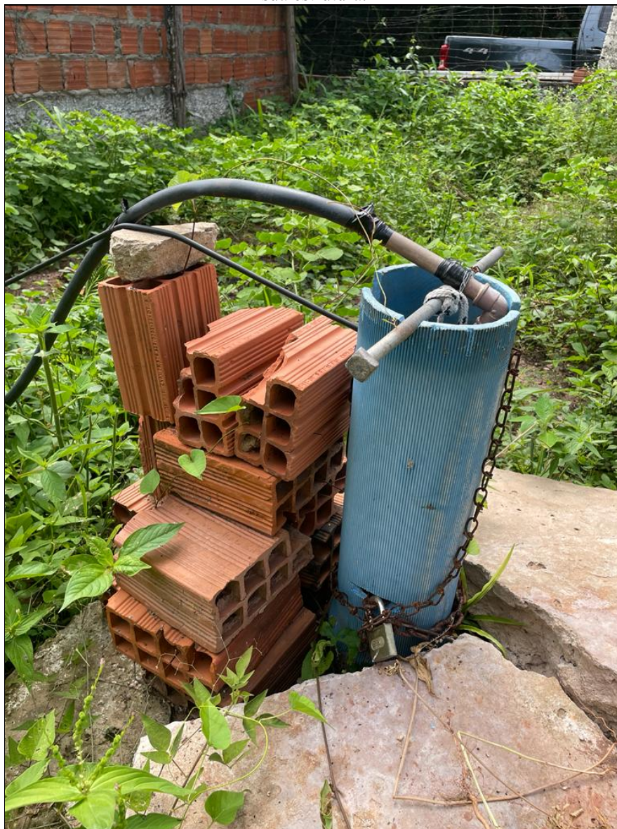
Figura 2 - Poço do Povoado Taboca do Pau Ferrado, amarrado com correntes e com tijolos sendo usados para auxiliar na sua estrutura.
