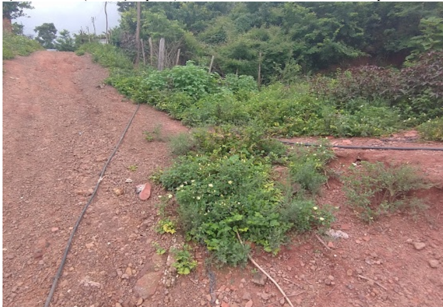
Figura 18 – Derivações de rede (tubulação preta) vinda dos reservatórios auxiliares para atendimento das famílias.
