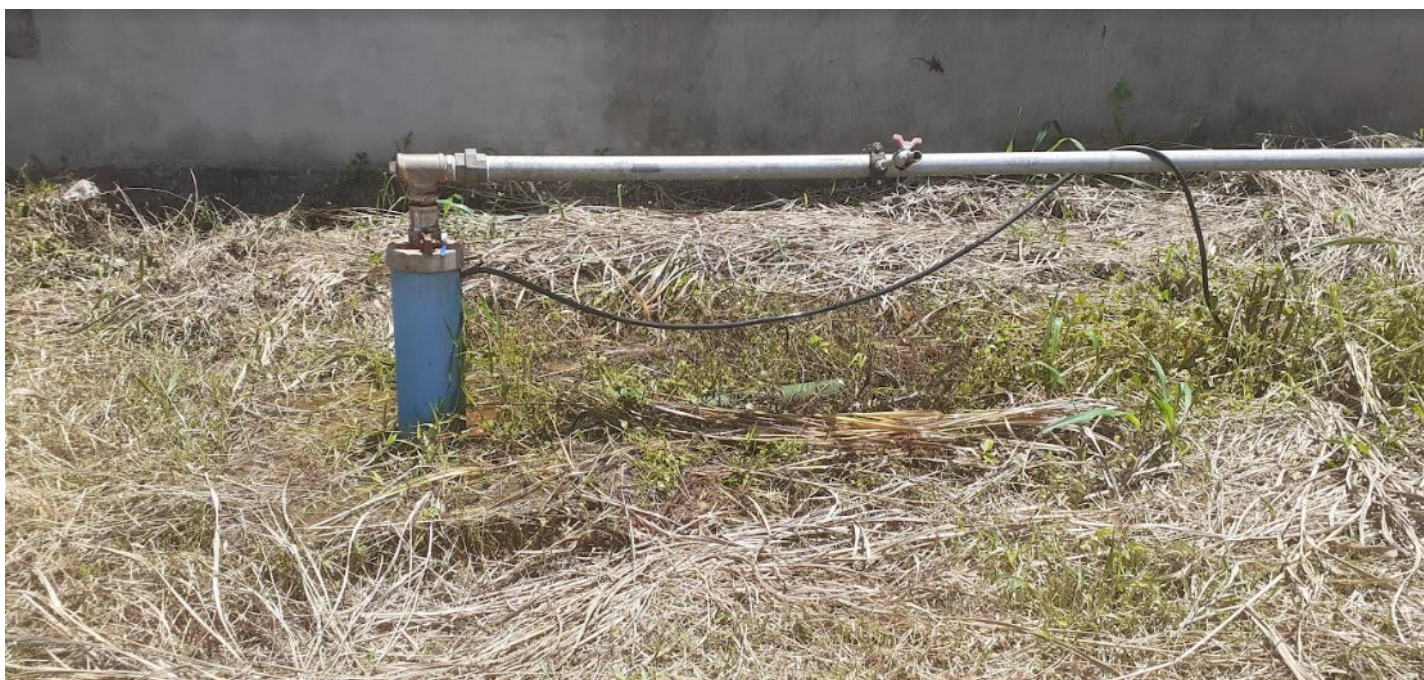
Figura 2 – Vazamento de água no poço localizado do Povoado Torrões.
