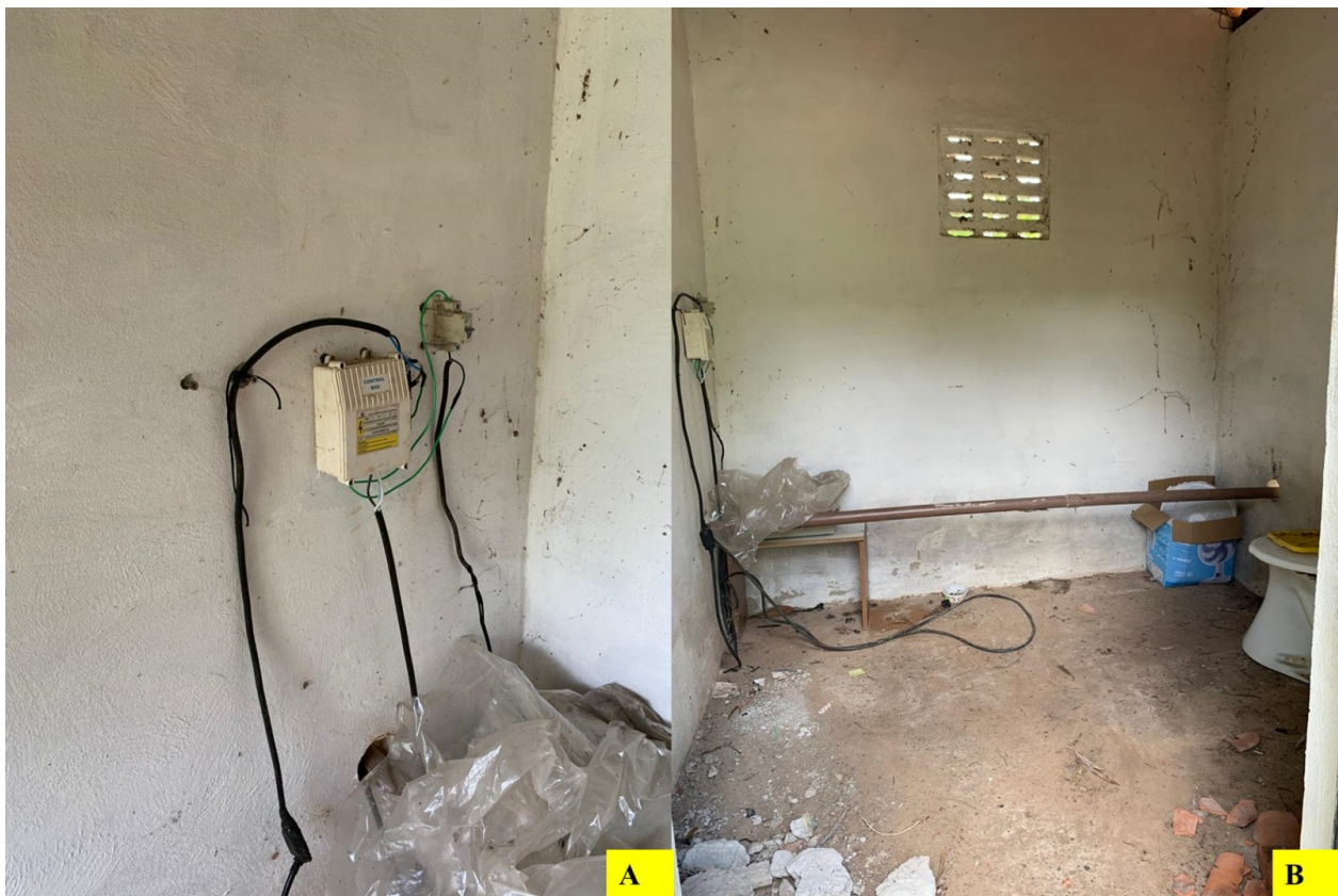
Fonte: Autoria própria (2023) Figura 9 - Poço3 - Captação (A) e Manobras do sistema (B)
