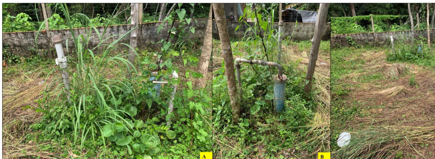
Figura 2 - Sistema de desinfecção inoperante (A), sistema de captação ativo e coberto por mato (B) e Limpeza do terreno irregular (C)
