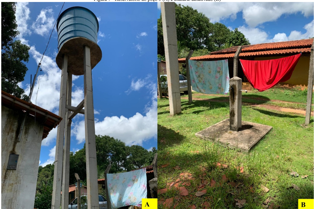
Fonte: Autoria própria (2023) Figura 8 - Quadro de comando elétrico irregular (A) e fiação exposta (B)
