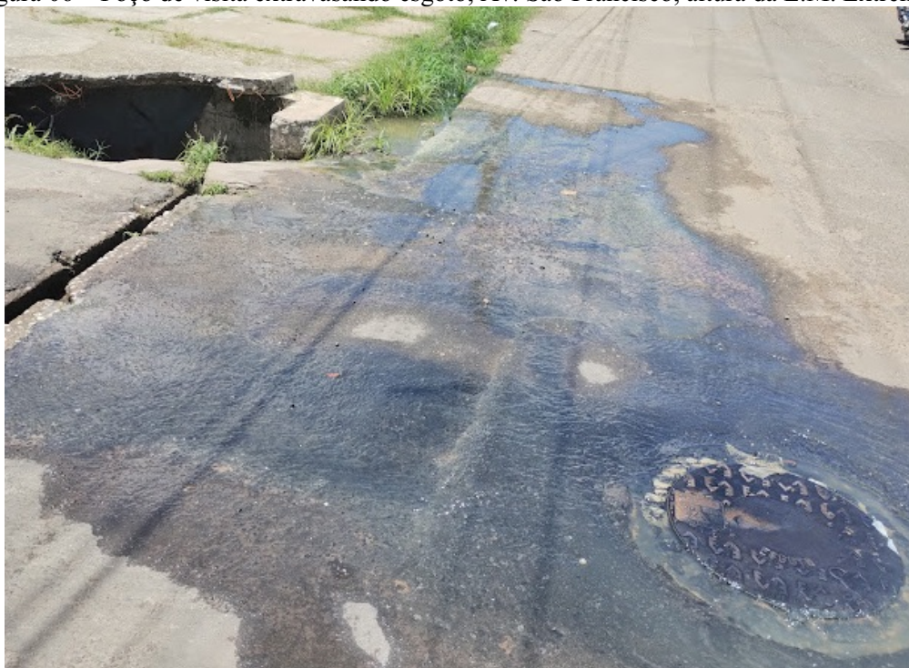
Figura 06 – Poço de visita extravasando esgoto, Av. São Francisco, altura da E.M. Extrema.
