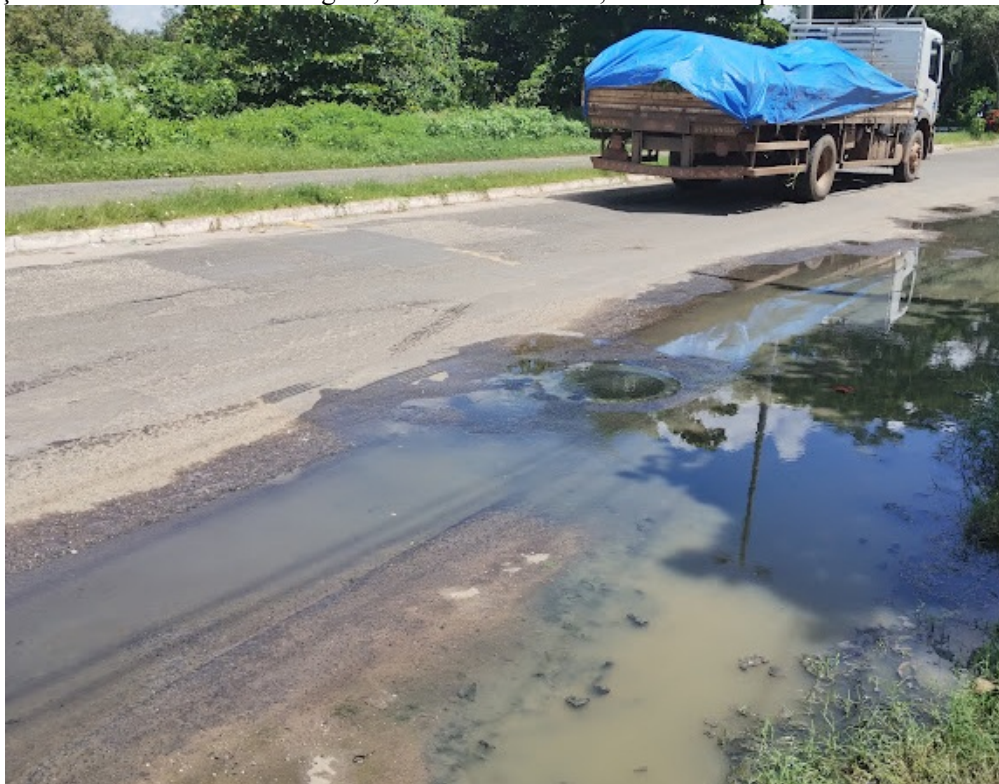
Figura 05 – Poço de visita extravasando esgoto, Av. São Francisco, altura do Esquadrão de Polícia Militar Montada.
