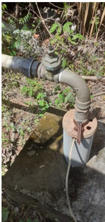
Figura 4 - Poço 01 do Povoado Taboca do Pau Ferrado, cavalete do sistema de captação de água com vazamento.
