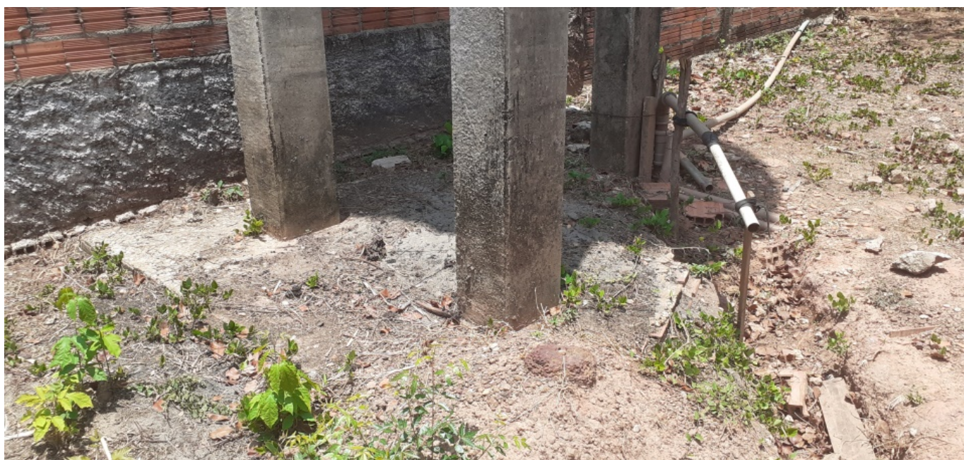
Figura 8 - Poço 02 do Povoado Taboca do Pau Ferrado, sapata do reservatório está deteriorada.
